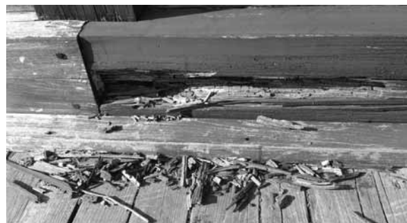
腐食が進む公園内の橋
