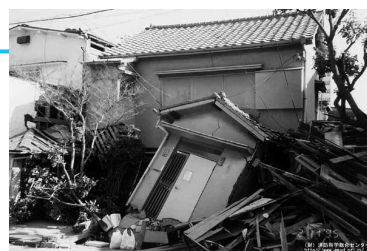
▲ 震災による倒壊家屋
